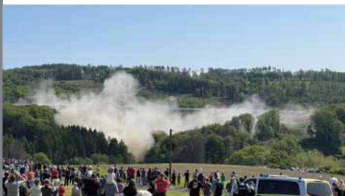
Ersatzneubau der Talbrücke Sterbecke Vermessungstechnische Begleitung der Sprengung der alten Talbrücke Sterbecke
