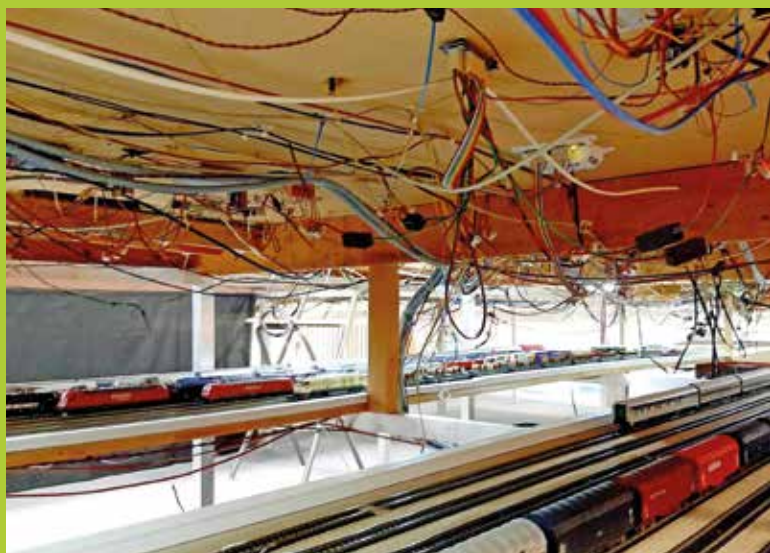
Ein Blick unter den Tisch in die Technik
